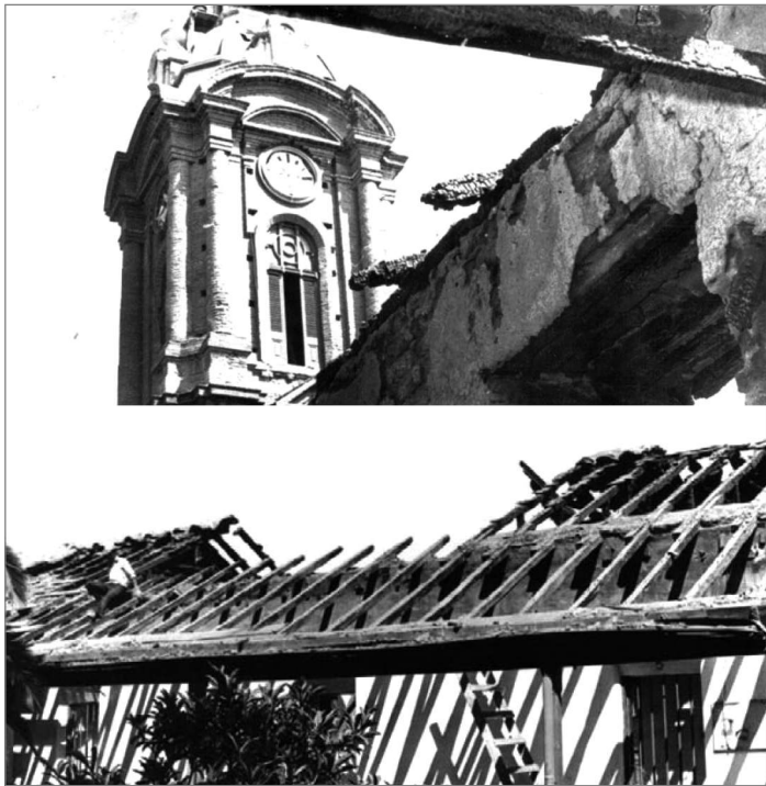
Figura 20. La Iglesia de San Francisco después del incendio (1983) Figure 20. The San Francisco Church after the fire (1983)
