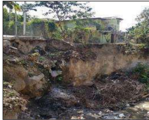
Imagen 7 Vivienda en zona de riesgo en Santa Inés Fuente: PACHA estudio
